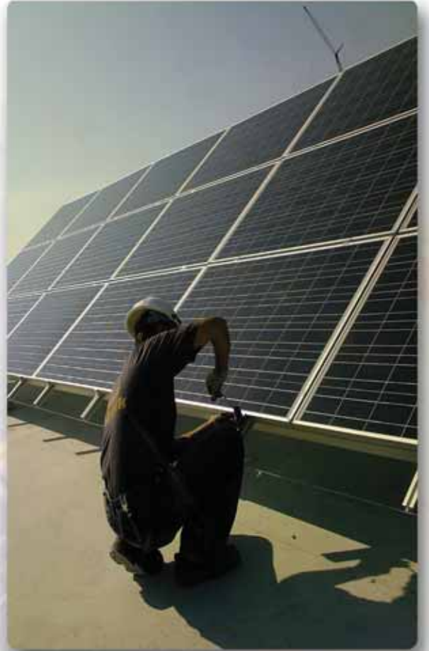
Turkcell Çeşme Baz İstasyonu Kurulumu
