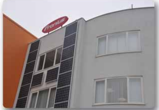
Fronius Binası Fotovoltaik Cephe Uygulaması
