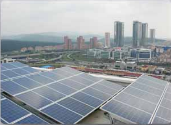
Anel İş Merkezi 22 kW Çatı Kurulumu
